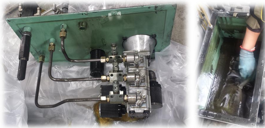
Figura 8: Bomba y tanque con aceite en mal estado
