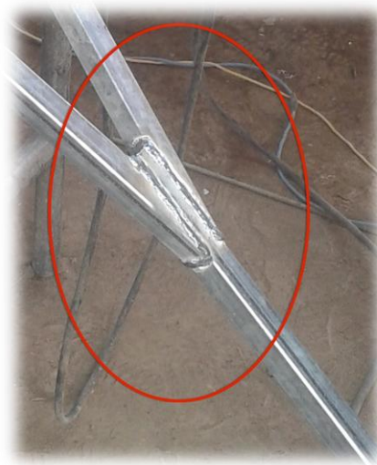
Figura 81: Apariencia de soldadura
