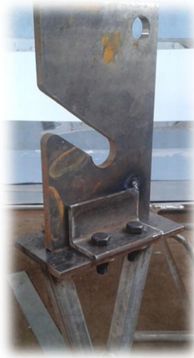
Figura 80: Base de rodillo coincide con base de la estructura
