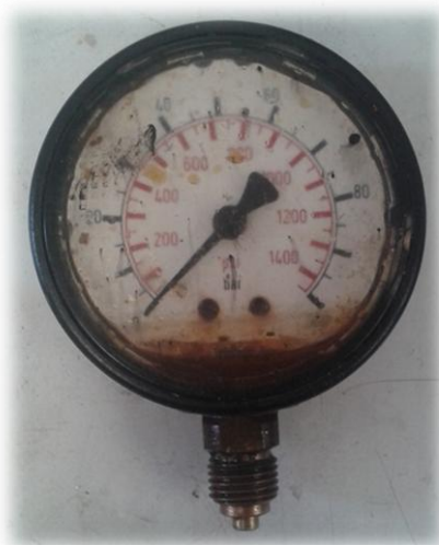
Figura 72: Manómetro en mal estado
