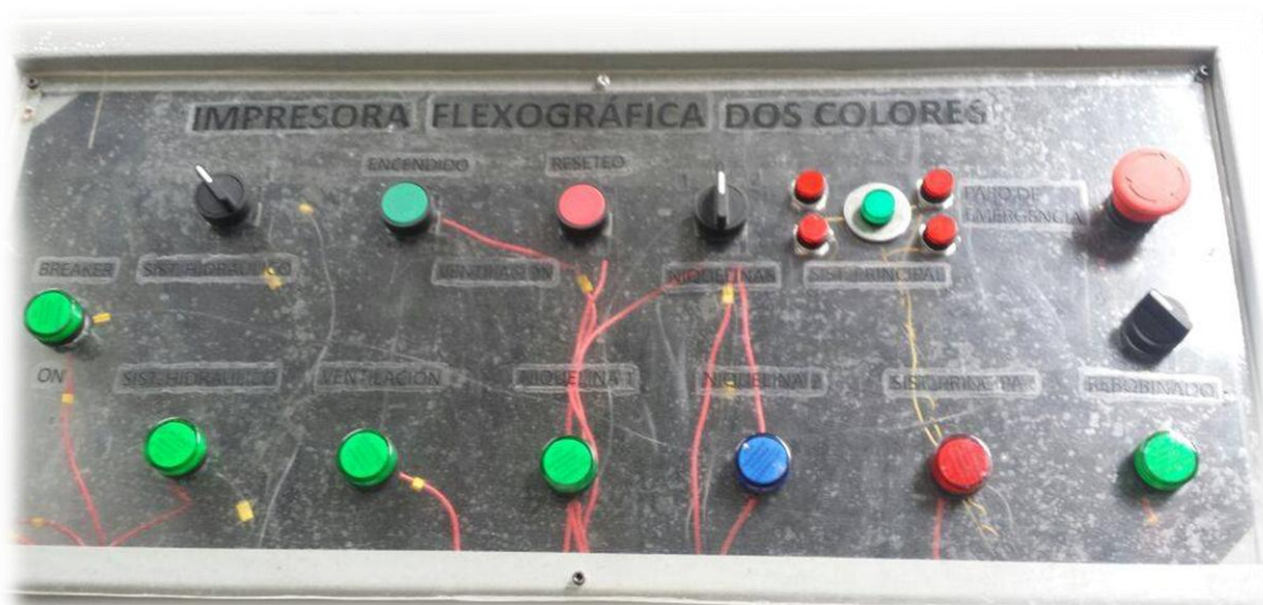
Figura 90: Parte exterior del tablero de control
