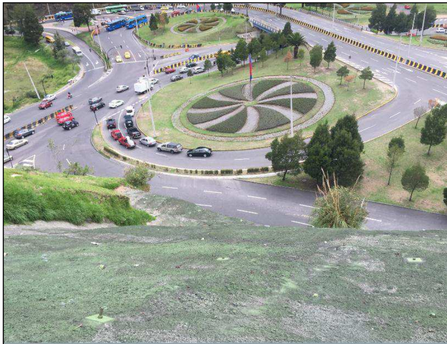
Figura 41. Talud N°1 ubicado junto al mural de Manuela Sáenz
