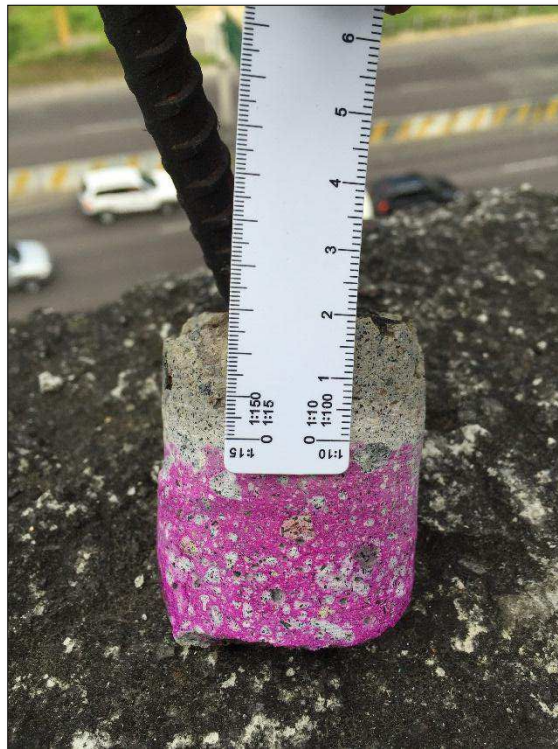
Figura 29. Ensayo de carbonatación con indicador de fenolftaleína
