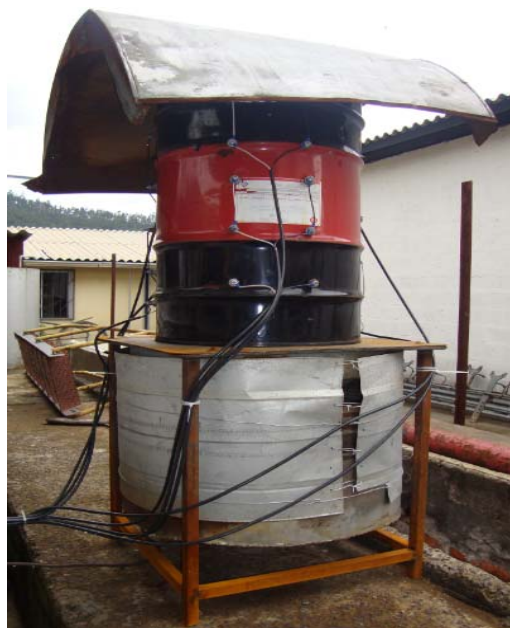
Figura 20. Banco de resistencias eléctricas utilizado como carga del motor
