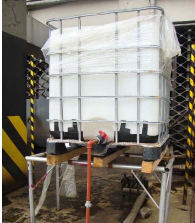
Figura 18. Sistema de transferencia de combustible instalado (tanque de servicio para el almacenamiento de combustible)
