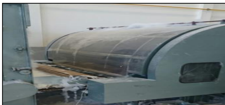
Figura 13 Maquinaria sin mantenimiento
