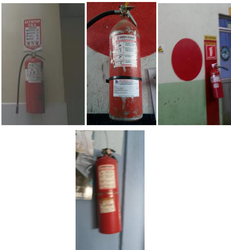
Figura 37 – Extintores de emergencia portátiles
