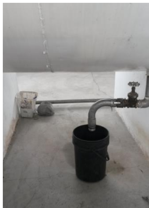
Figura 56, 57 Tanques de Almacenamiento de JP1, diseño de cubeto no cumple con la normativa
