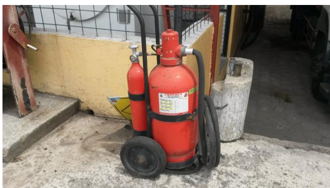
Figura 38 Extintores de emergencia de 100 kilos
