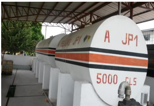
Figura 90 Almacenamiento de Combustible
