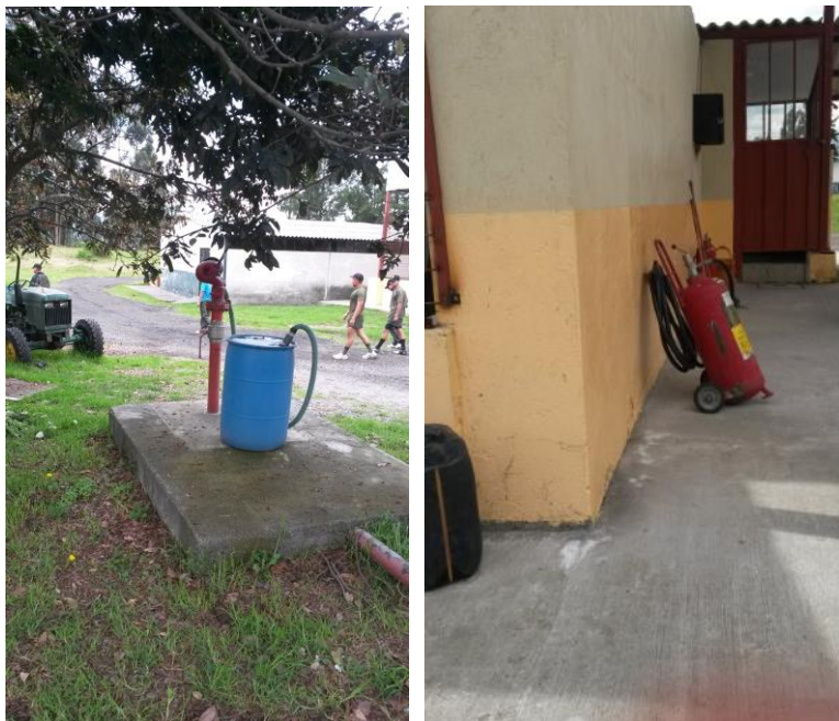
Figura 39 y 40 Sistema de espuma y extintor en la gasolinera
