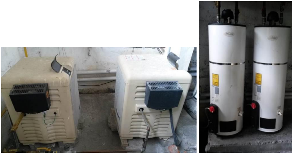
Figura 33 Cuarto de máquinas (bombas y calderos), no reciben mantenimiento periódico
