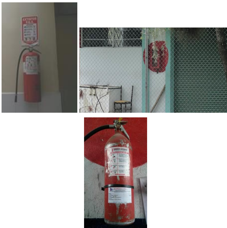
Figura 22 Extintores de emergencia
