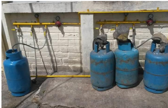
Figura 35 Tanques de gas de la cocina a la intemperie
