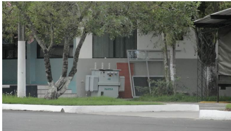
Figura 58 Desechos peligrosos (PCB) sin almacenamiento adecuado
