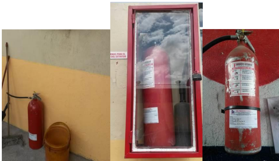
Figura 34 Presencia de extintores de emergencia en áreas administrativas, mecánica, cocina, sin embargo no todas las áreas cuentan con extintor
