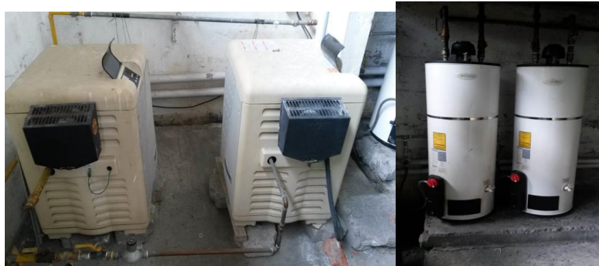
Figura 56 Bombas para la piscina y calderos para piscina
