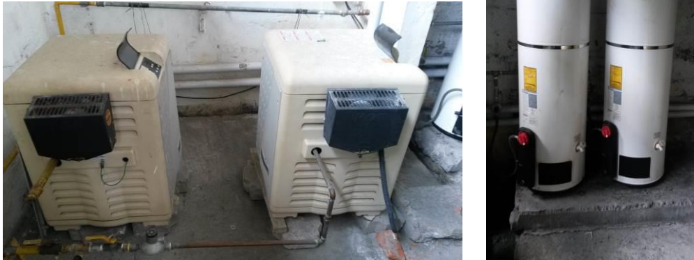
Figura 14 Bombas y calderos del área de la piscina
