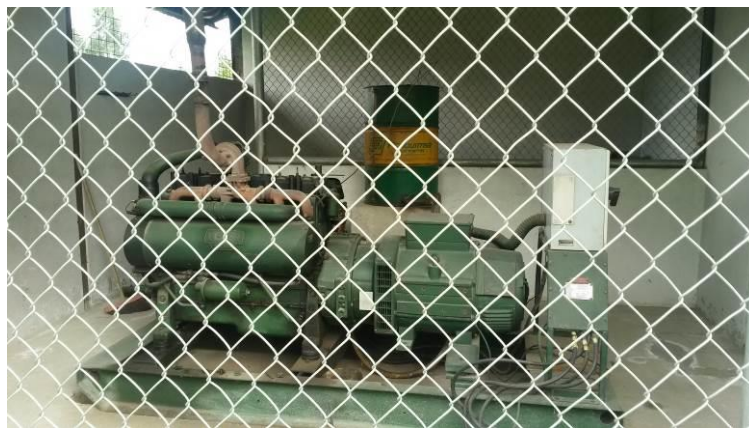
Figura 21 Generador de emergencia
