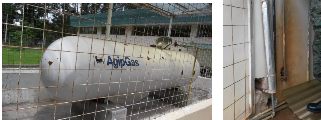
Figura 15 Falta de señalética y tuberías pintadas de acuerdo a la norma
