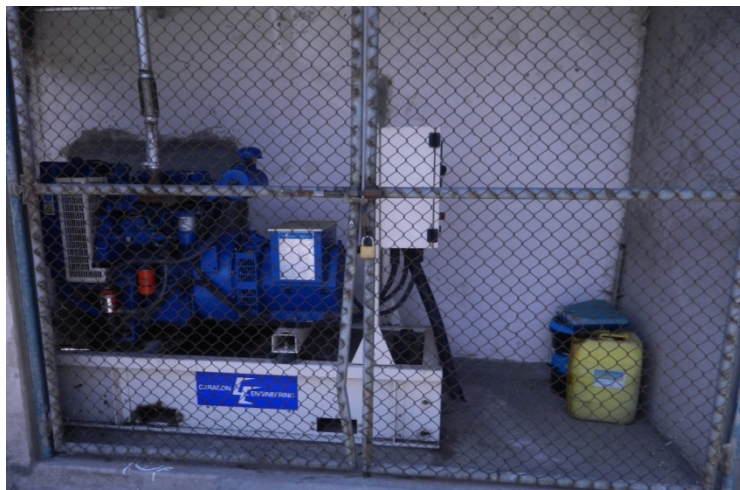
Fotografía 18. Generador eléctrico de emergencia
