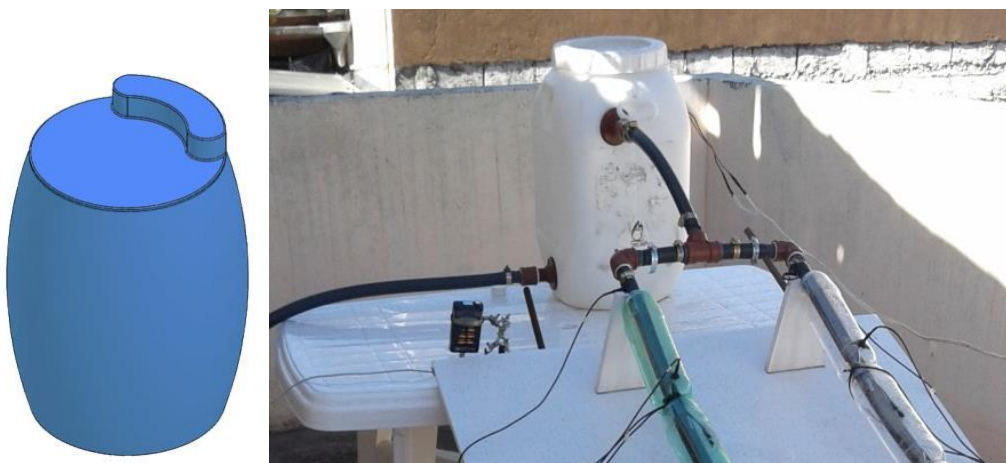
Figura 20 Acumulador de agua caliente con capacidad de 25 litros, manímetro de alimentación de agua caliente con dos entradas.
