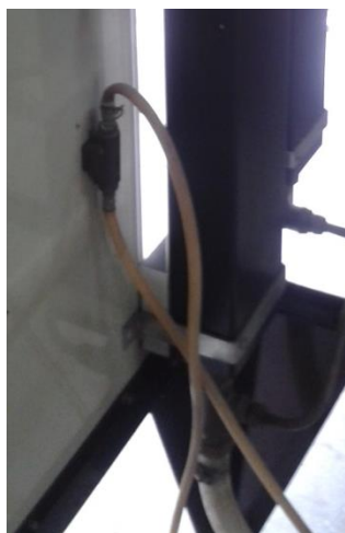
Figura 26 Tubería para el paso de agua.
