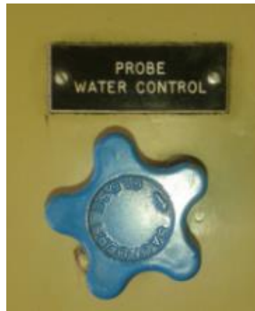
Figura 13 Válvula de Paso de Agua al Tubo Pitot
