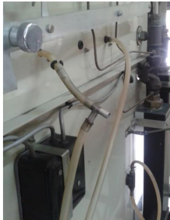
Figura 23 Mangueras PVC para el Paso de Aire.
