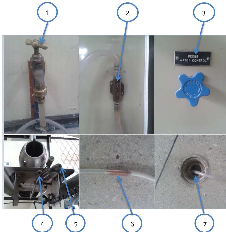
1. Toma de Agua para Refrigeración; 2. Válvula de paso de Agua; 3. Control de Paso de Agua; 4. Punto de Salida del Agua del Tubo Pitot; 5. Punto de Ingreso del Agua al Tubo Pitot; 6. Acople para el paso de Agua; 7. Sifón de Desagüe.
