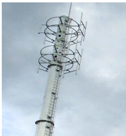
Figura 93 Monopolo construido disponible para instalación
