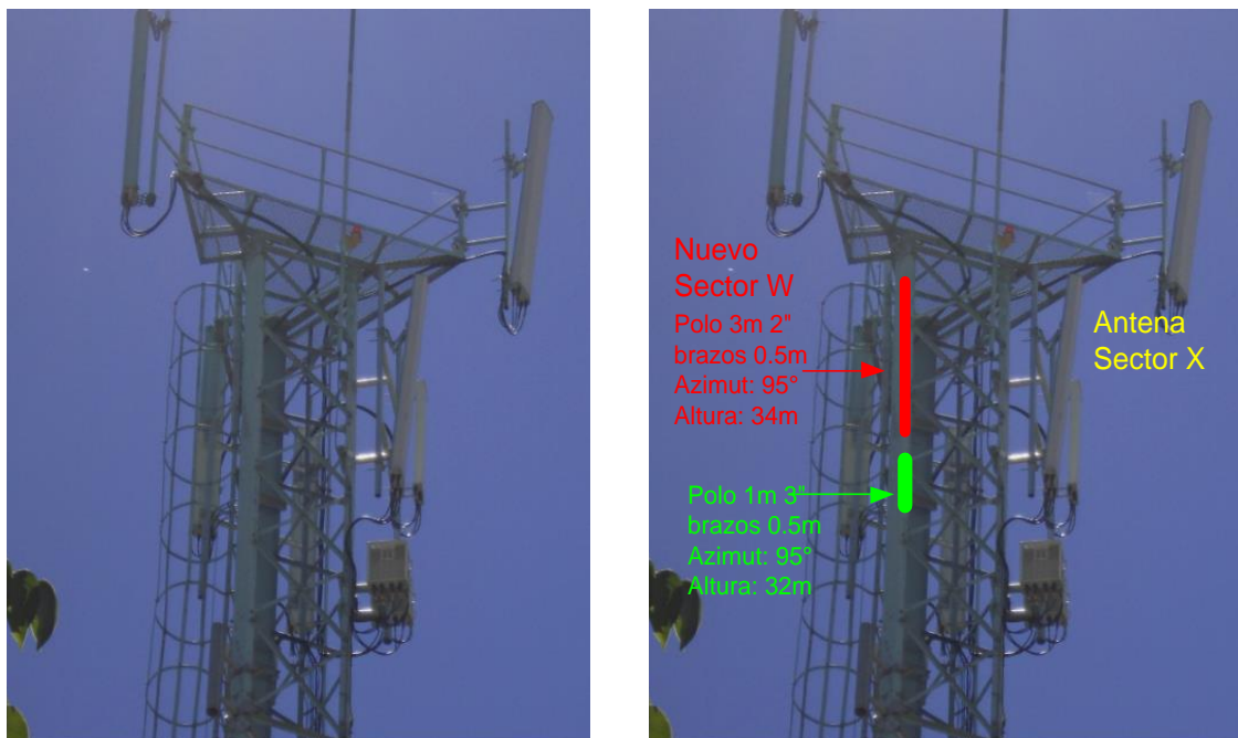
Figura 111 Estado inicial de torre ARMENIA
