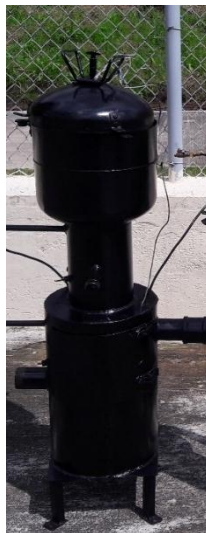
Figura 15 Reactor del Gasificador
