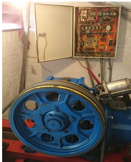
Figura 33. Vista frontal del tablero de control y máquina de tracción del ascensor
