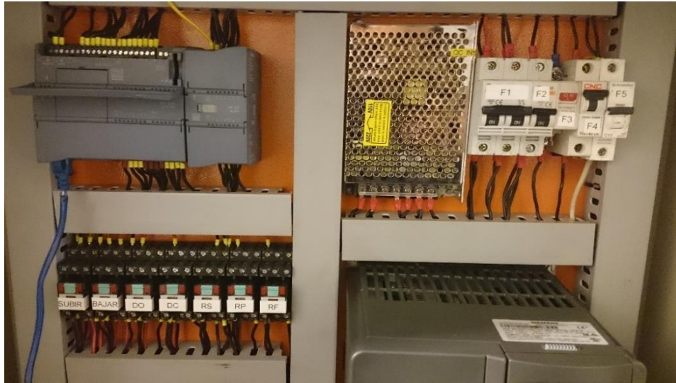
Figura 56. Etiquetado componentes de control y protección
