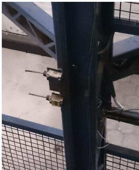
Figura 71. Límites inferiores del ducto del ascensor
