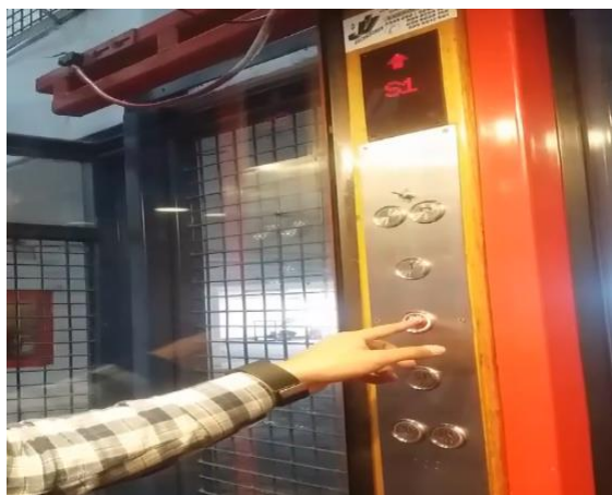
Figura 68. Prueba de botones dentro de cabina del ascensor
