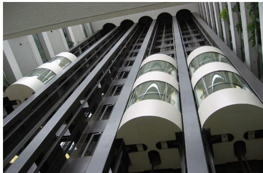
Figura 27. Grupo de ascensores
