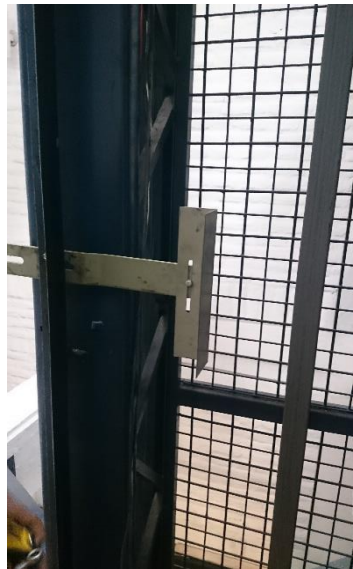
Figura 74. Ajuste de banderolas para mejorar la nivelación del ascensor
