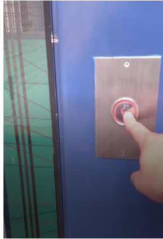
Figura 75. Prueba de botonerías de pasillo
