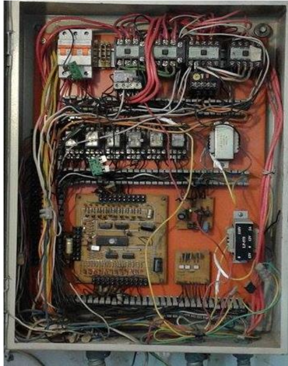
Figura 32. Cuadro de control antiguo del ascensor
