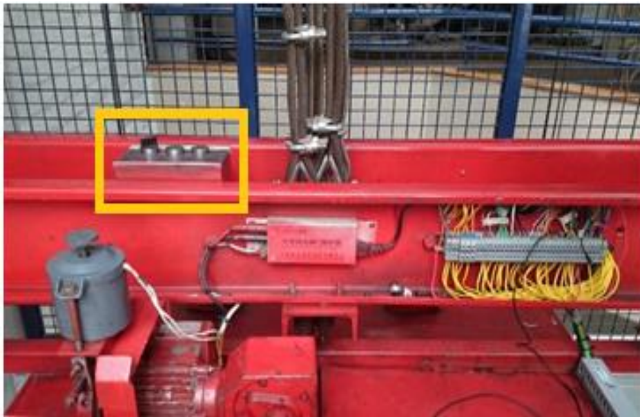
Figura 62. Botonera de inspección sobre la cabina del ascensor
