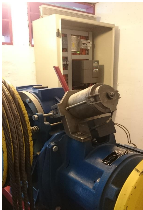
Figura 52. Ubicación del control electrónico en el cuarto de máquinas del ascensor
