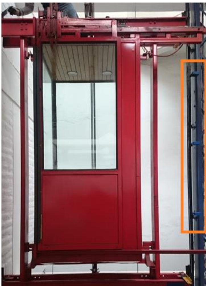
Figura 65. Sensores de ducto del ascensor
