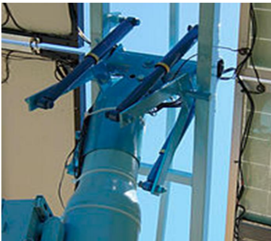
Figura 15: Sistema de Seguimiento Solar
