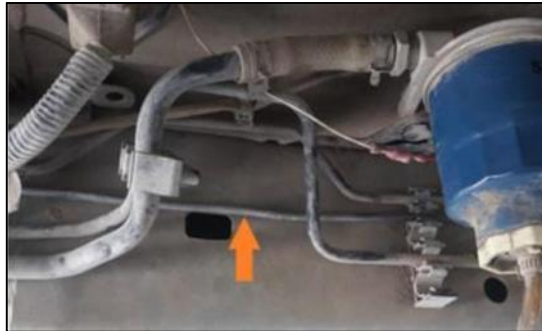
Figura 21 Tubería de alta presión.
