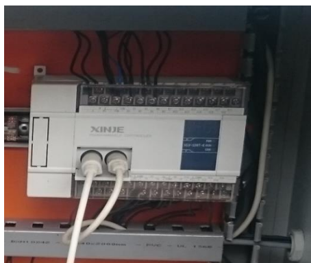
Figura 101. Conexión del PLC.
