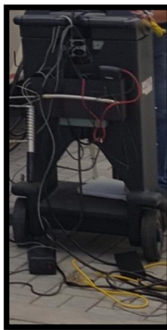
Figura. 32 Conexión del analizador
