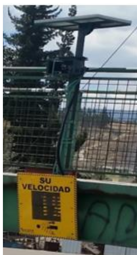
Figura 67: Panel montado en estructura
