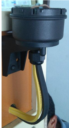
Figura 92. Conexión del cable AS-i amarillo y Aux negro
