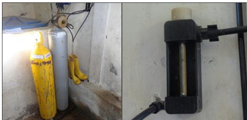
Figura 12. Zona de Cloración
