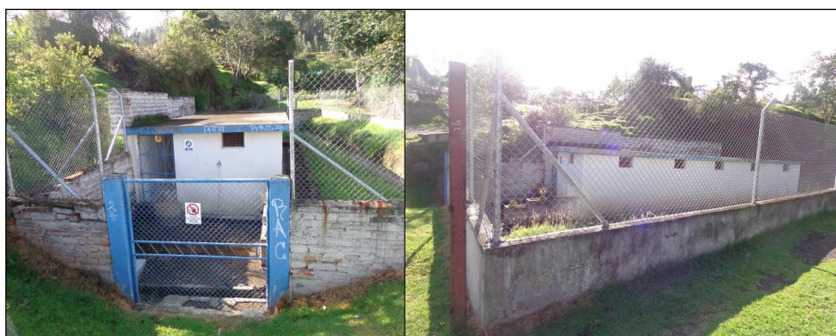
Figura 10. Estructura de protección de la vertiente Cotogchoa
