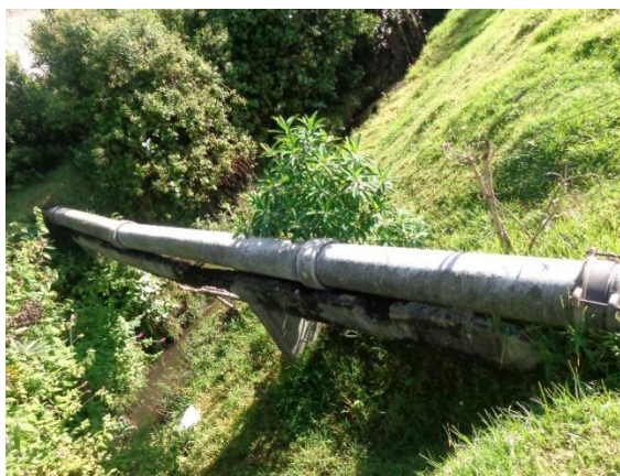
Figura 16. Tubería derivada hacia el Tanque Albornoz
