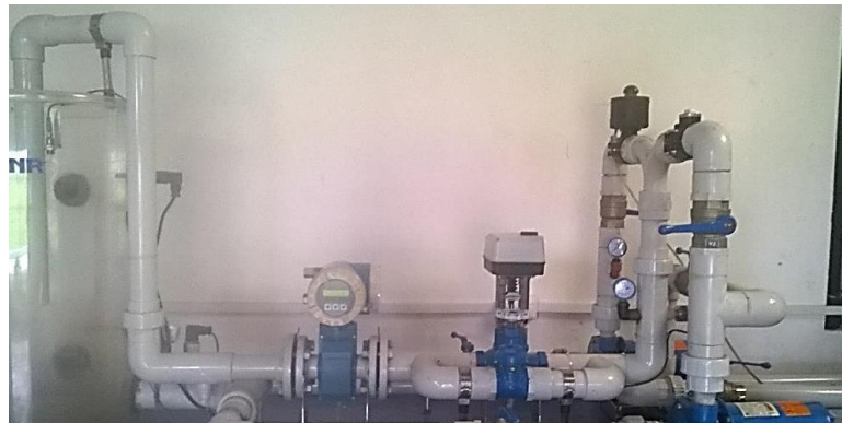
Figura 37 Tubería de descarga
