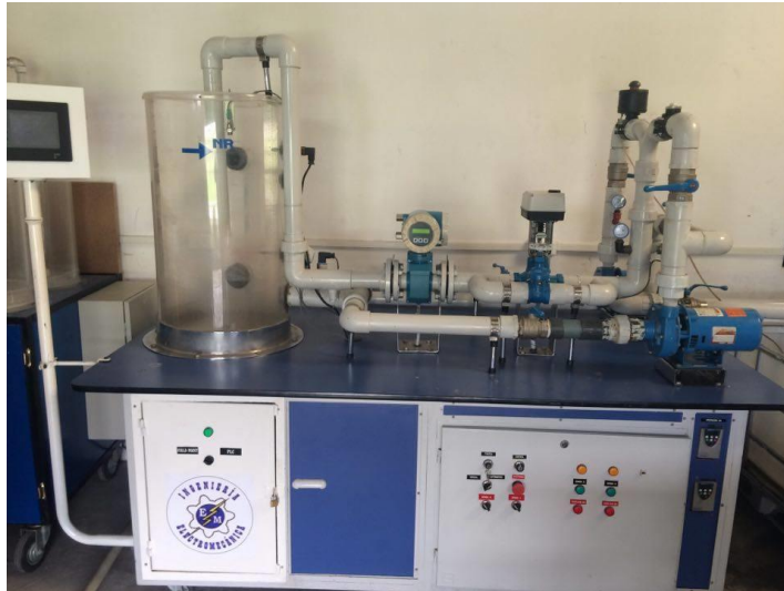
Figura 34 Sistema de Bombeo
