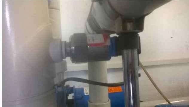
Figura 40 Transductor de presión de descarga Cerabar
