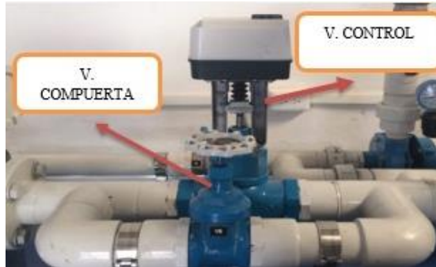
Figura 42 Válvula de compuerta y Válvula de control
