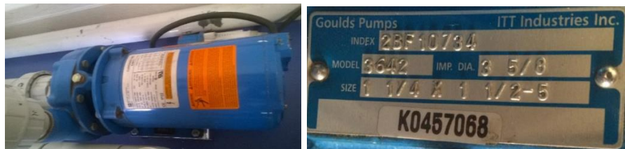
(a) Bomba centrífuga
