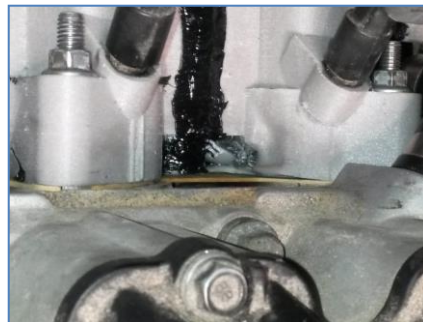
Figura 171. Múltiple PET armado.
