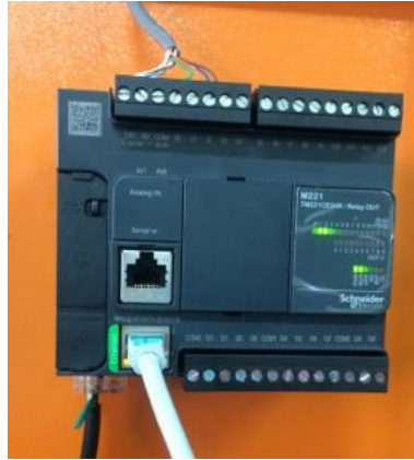
Figura 86 Conexión del PLC Schneider
