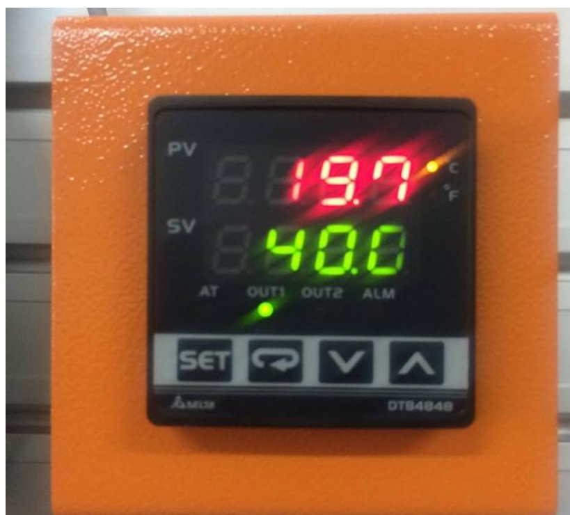
Figura 178 Visualización del Controlador de Temperatura
