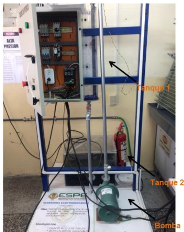
Figura 186 Estación del Variador Delta 1 (VFD1)
