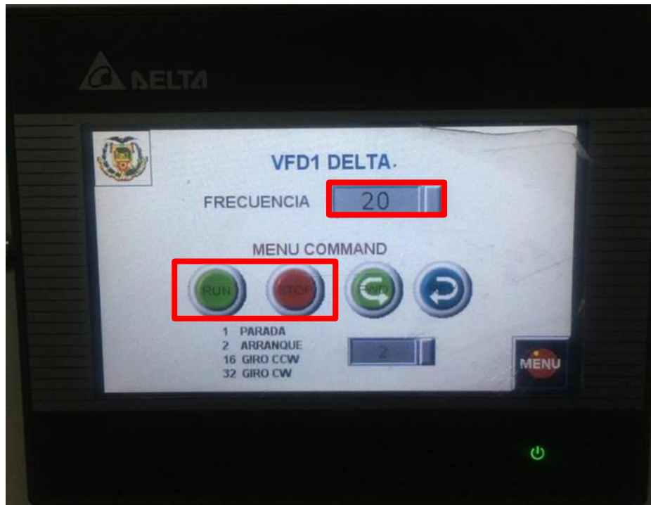
Figura 171 Arranque y asignación de frecuencia del variador VFD1
