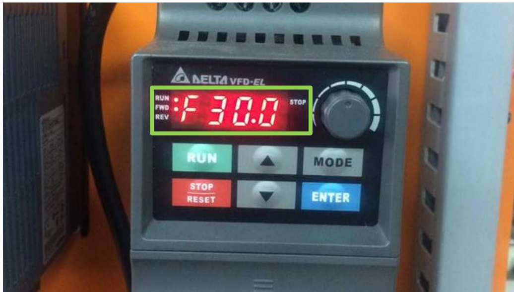
Figura 190 Display del VFD2 en funcionamiento
