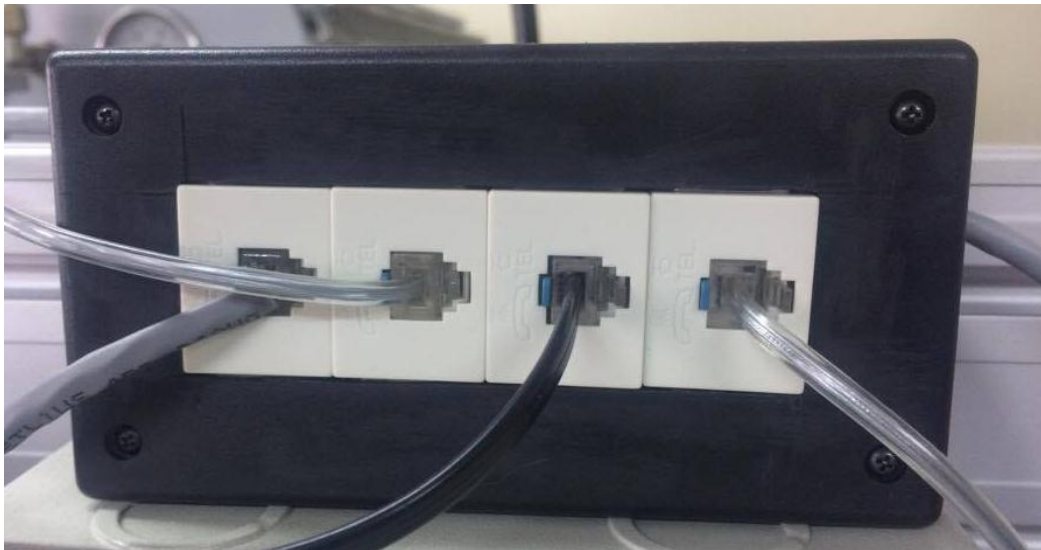
Figura 80 Switch para el Bus RS485
