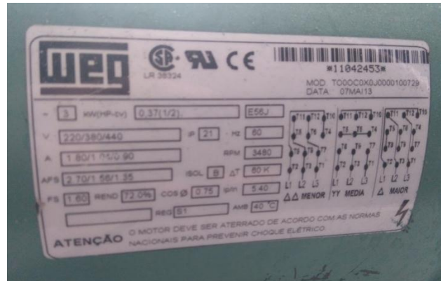
Figura 75 Placa de características del motor de la bomba hidráulica
