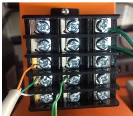
Figura 82 Conexión del controlador de temperatura Delta DTB4848
