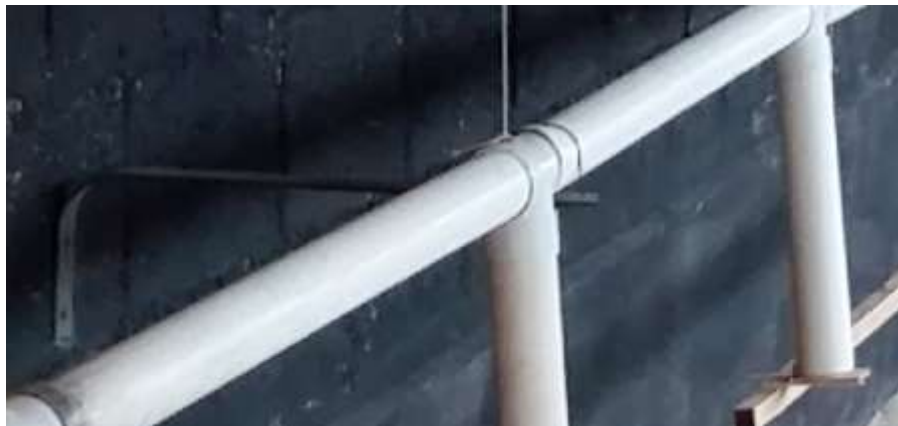
Figura 70: Soportes de pared y cable tensor
