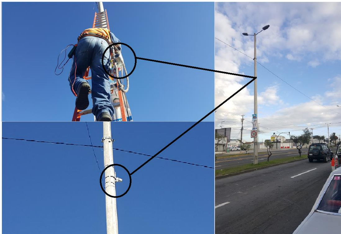
Figura 18 Instalación de cámara de video
