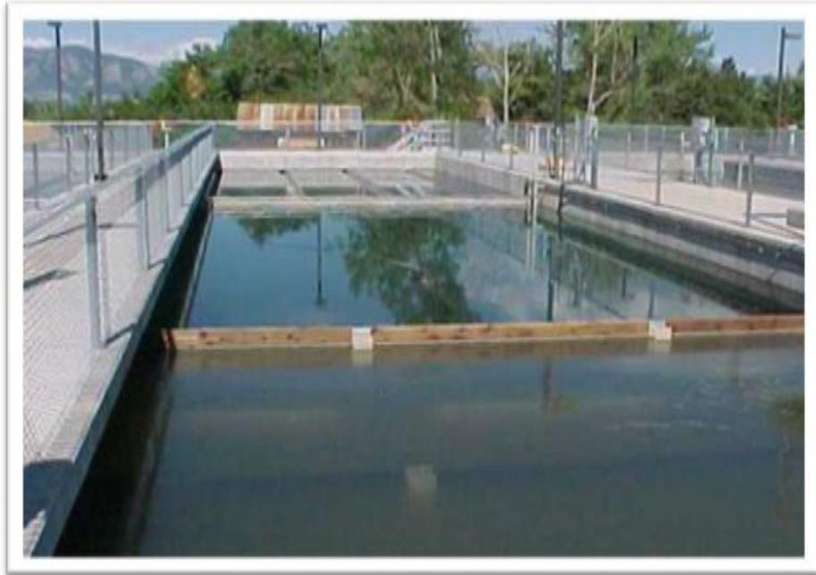
FOTO 2: Planta de Tratamiento
