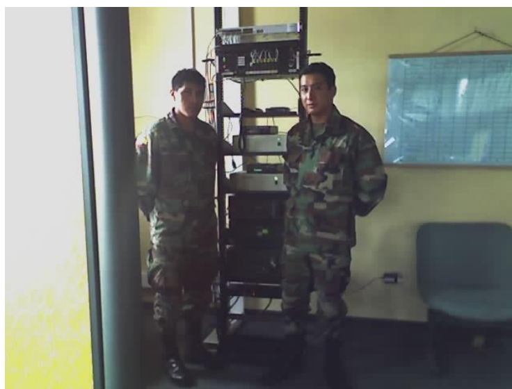
Figura. 5.6. Equipo ACU-1000 totalmente Instalado en el LIS COCOM
