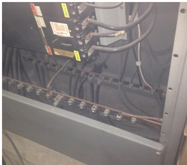
Figura 78. Punto de medición Cuarto de bombas de agua.
