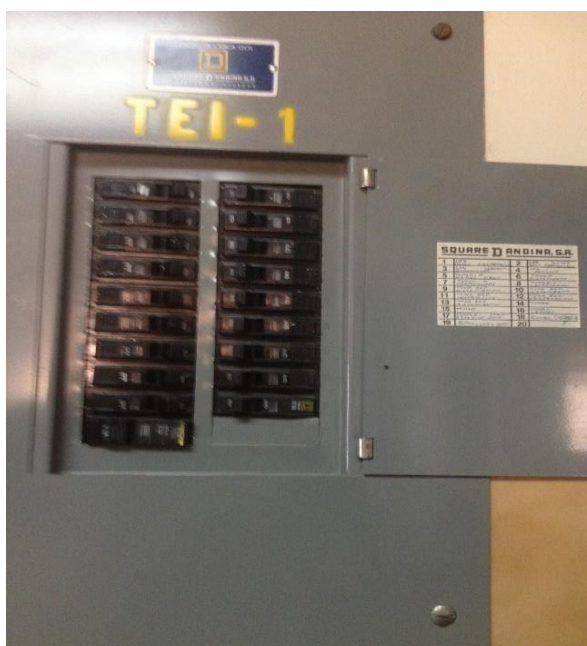
Figura 50. Tablero de emergencia planta 1.
