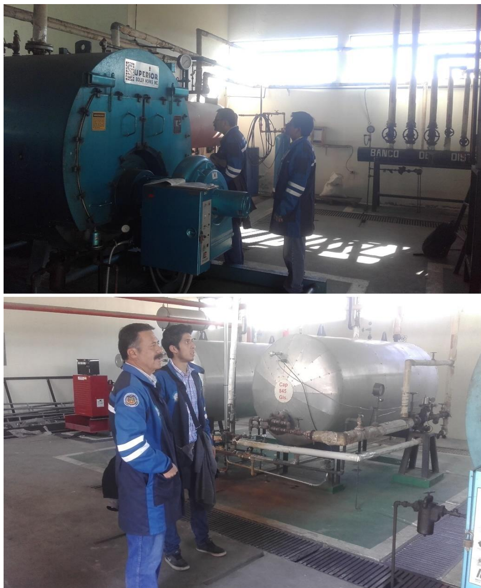
Figura 94. Sistema Generador de Vapor del Hospital del IESS Latacunga.
