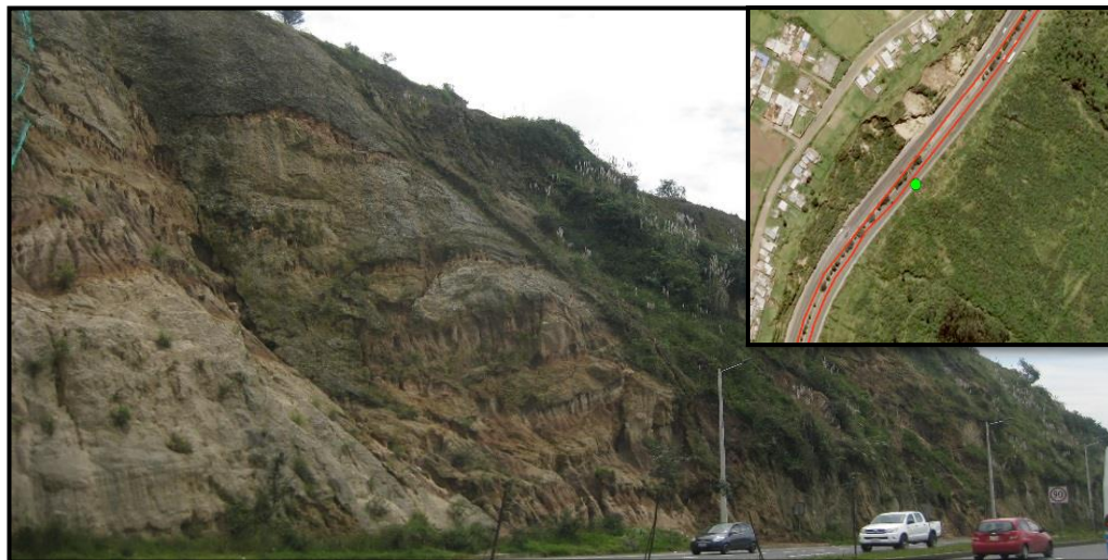
Figura 13. Zona vulnerable a movimiento en masa
