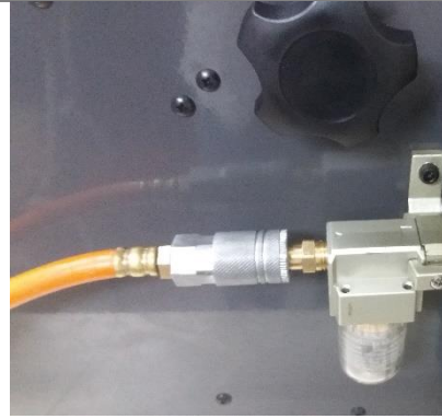
Figura 49 Manguera de aire del compresor
