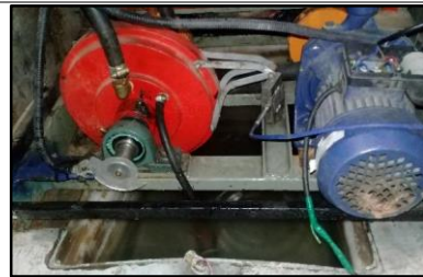
Figura 103 Alojamiento de la bomba hidráulica
