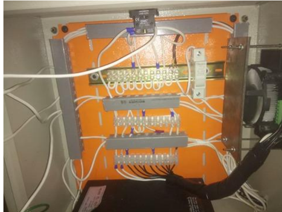
Figura 60 Ubicación de los elementos de control en el gabinete
