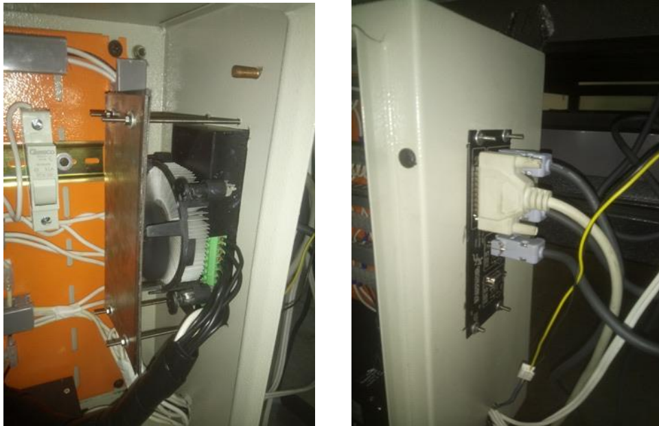
Figura 84 Ubicación driver y ventilador en el gabinete de control
