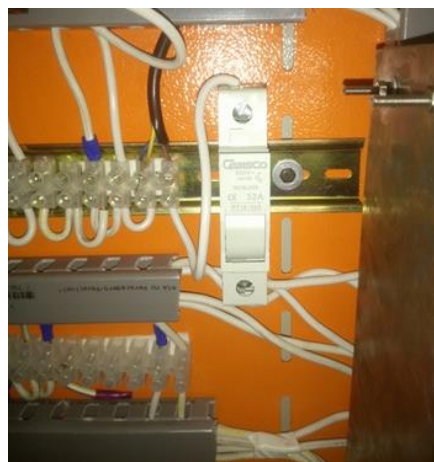
Figura 83 Ubicación portafusibles en riel DIN gabinete de control
