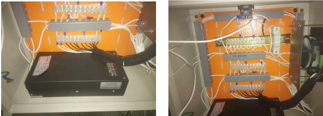
Figura 85 Ubicación fuente de alimentación y canaletas en gabinete de control
