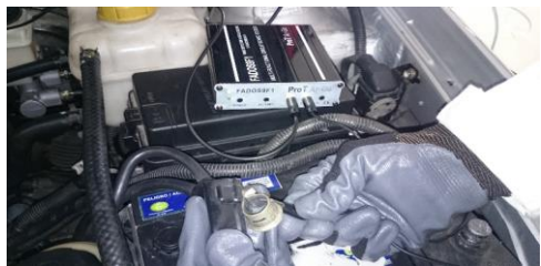
Figura 16. Conexión de la masa del equipo al cable negativo que conecta a la batería
