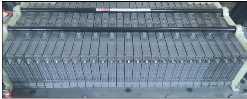
Figura 148: Bateria con celdas reemplazadas.
