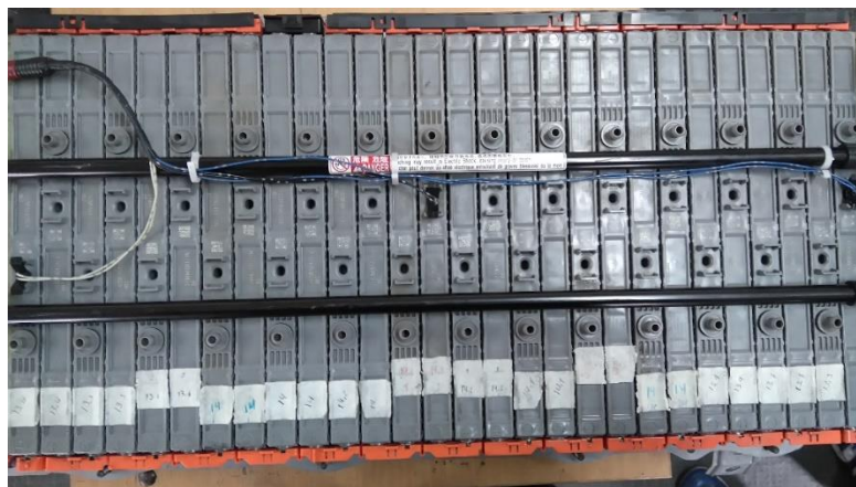
Figura 149: Bateria armada con celdas en buen estado
