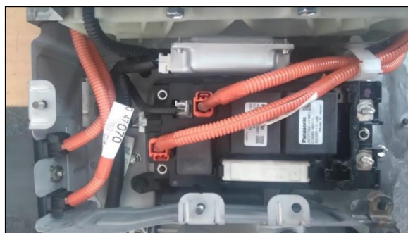
Figura 36: Relays batería HV Toyota Prius
