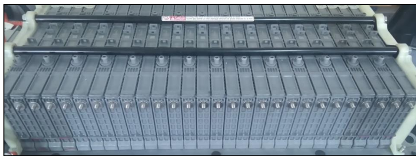
Figura 35: Celdas batería HV Toyota Prius
