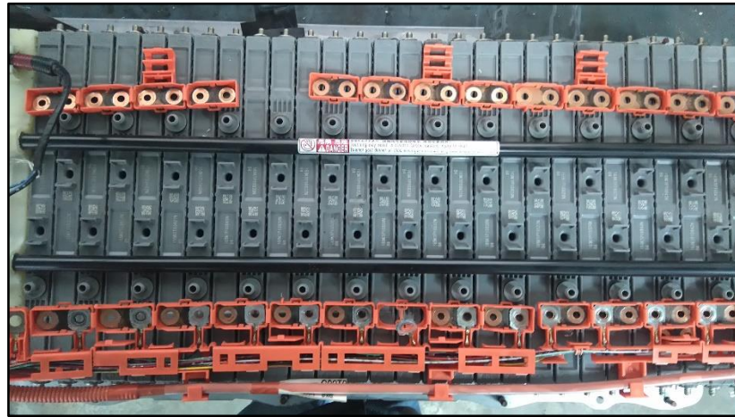
Figura 89: Bornes completos de la batería
