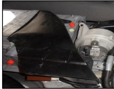
Figura 38: Conductos de refrigeración
