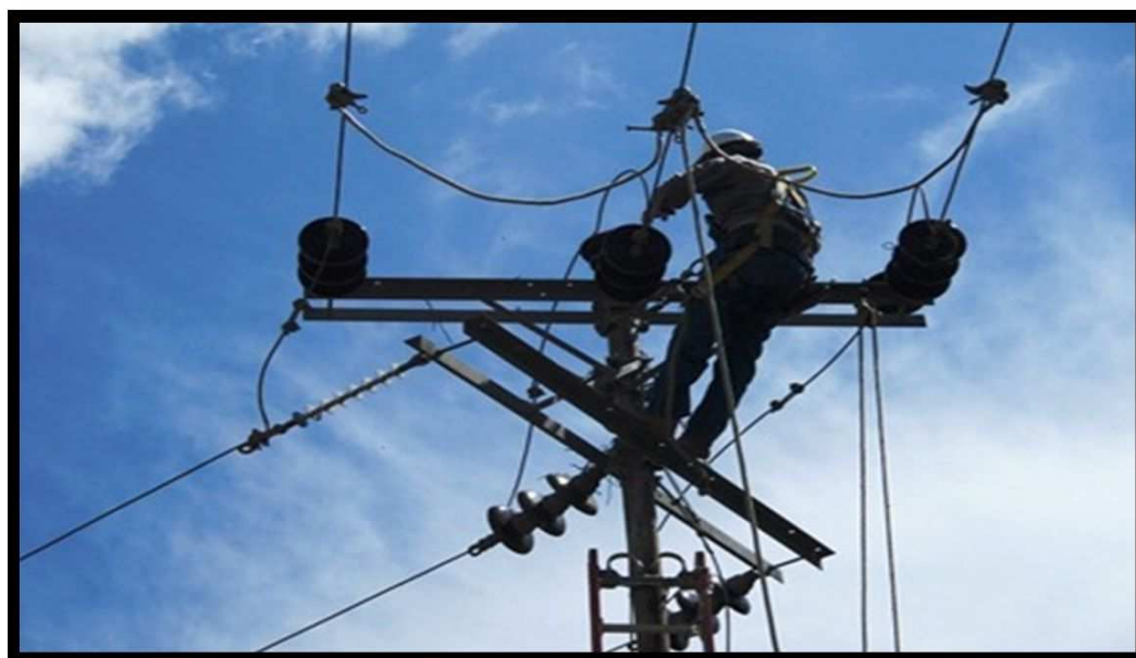
Figura 2.8: MANTENIMIENTO ELÉCTRICO CORRECTIVO Fuente: http://www.leanoticias.com/
