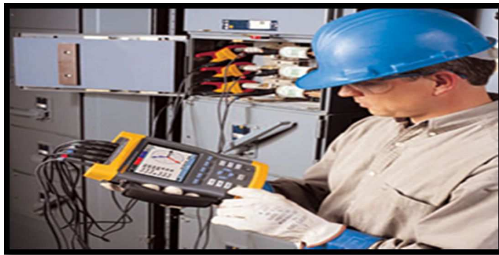
Figura 2.9: MANTENIMIENTO ELÉCTRICO PREDICTIVO Fuente: www.sieogroup.com
