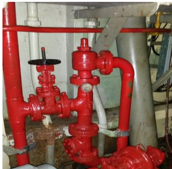
Figura. 2.5 Sistema contra incendio
