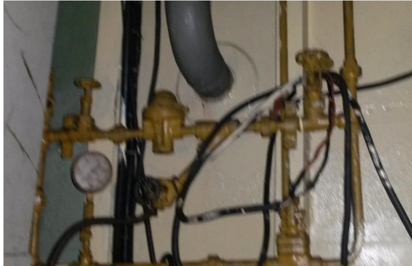
Figura. 2.7 Sistema de aire comprimido Fuente: BESMAR Elaborado por: Autora
