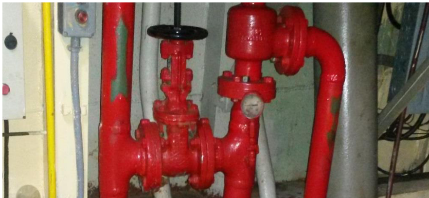
Figura. 4.5 Sistema contra incendio señalado
