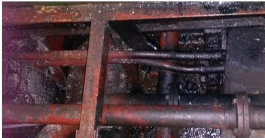
Figura. 4.1 Tubería bajo planchaje sin limpieza Fuente: BESMAR Elaborado por: Autora
