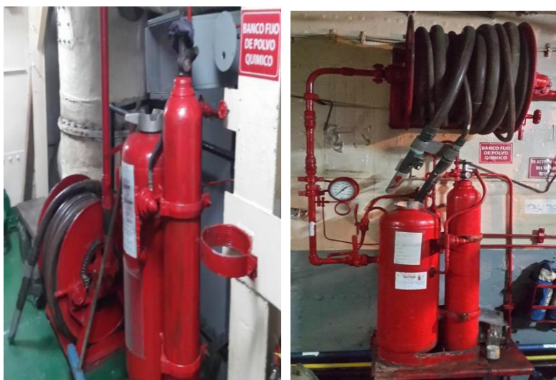
Figura 3.15 Fotografía de los bancos fijos de polvo químico Fuente y elaborado por: Andrés Idrovo González
