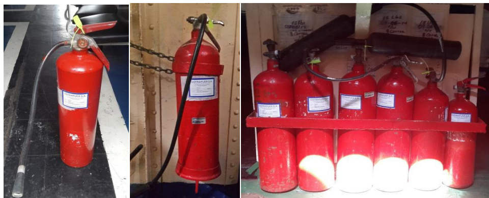
Figura 3.19 Fotografía de los extintores Fuente y elaborado por: Andrés Idrovo González
