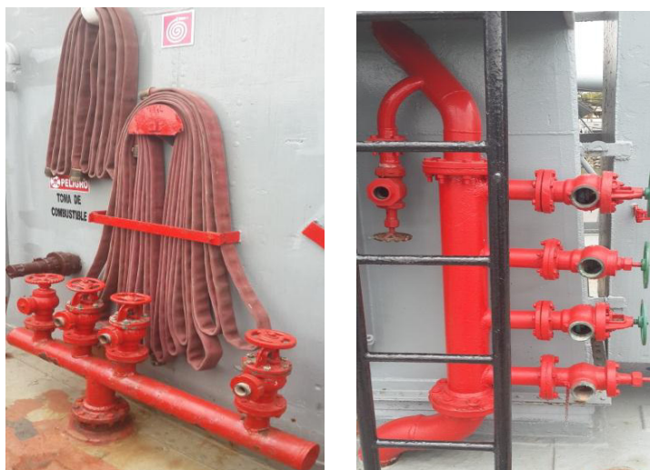
Figura 3.17 Fotografía de una toma contra incendio de 2 ½ Fuente y elaborado por: Andrés Idrovo González
