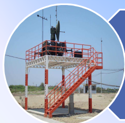
Antena de transmisión de datos.
