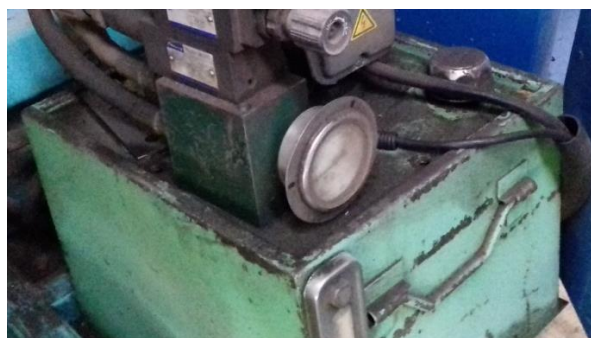
Figura 30. Depósito de fluido
