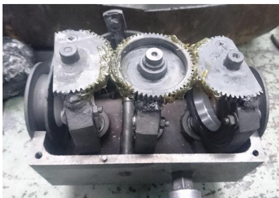
Figura 98. Limpieza y Engrasado de Sistema Repartidor
