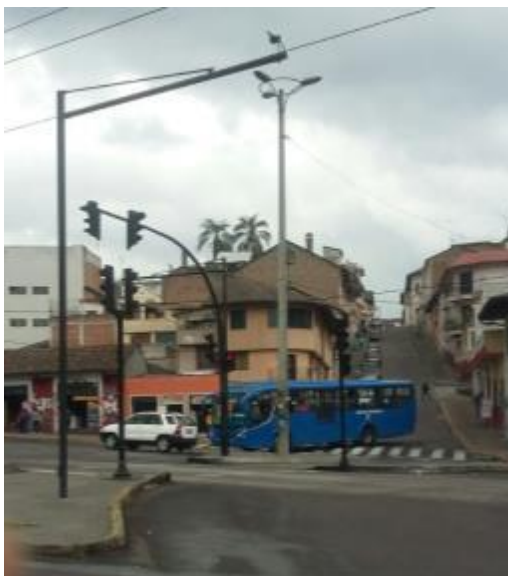
Figura 25. Sistema centralizado de semaforización adaptativo ubicado en el sector “La Marín”.
