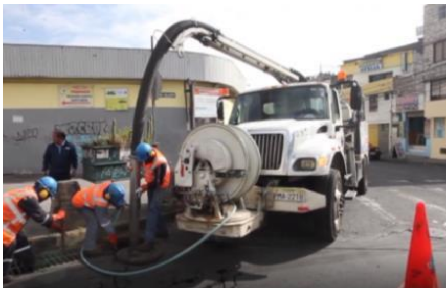
Figura 127. Hidro-sumidero realizando limpieza.
