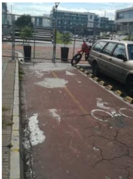
Figura 152. Pérdida de la continuidad de la Ciclovía a la altura de la Asamblea Constituyente.
