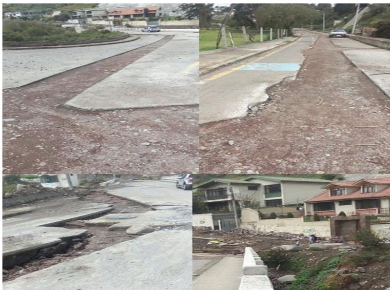
Figura 21. Canales colectores en la ciudad de Ambato
