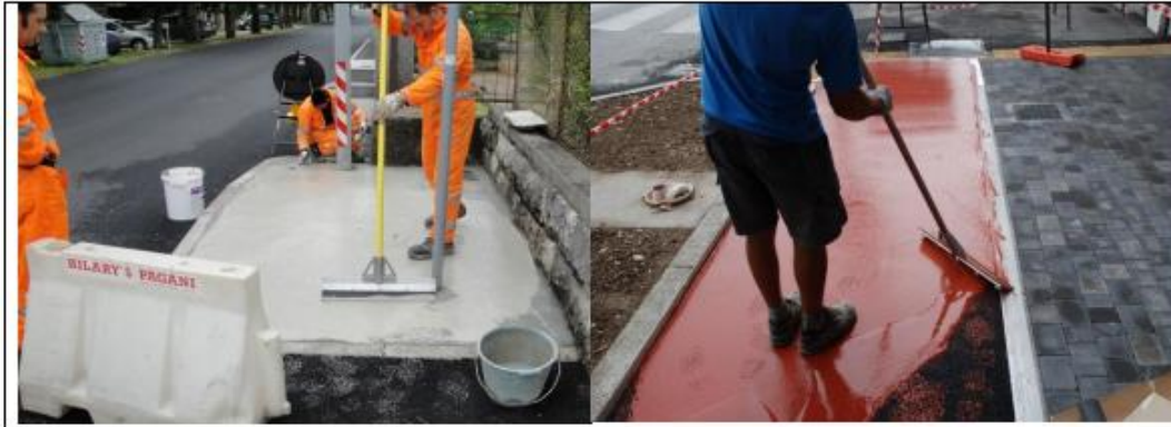
Figura 11. Pavimento de cemento con efecto fotocatalítico
