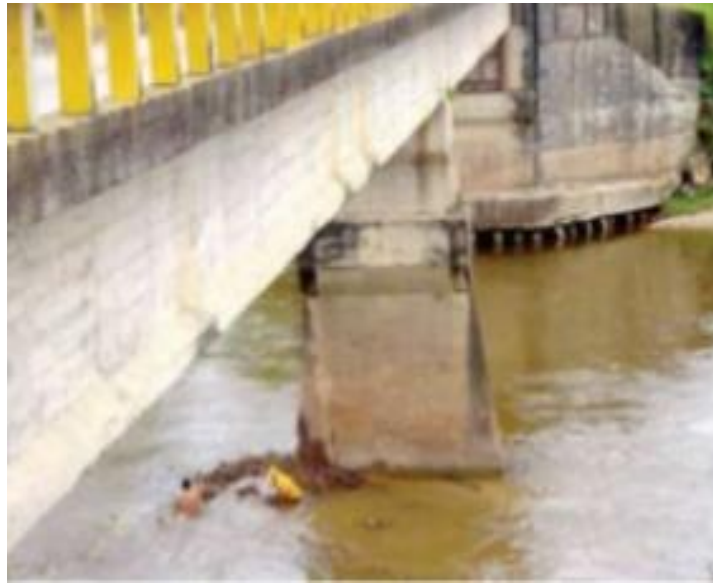
Figura 62 Socavación por estrechamiento Fuente: (Naranjo, SlideShare, 2011)
