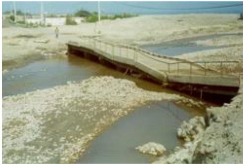
Figura 61 Socavación general Fuente: (Naranjo, Slideshare, 2014)
