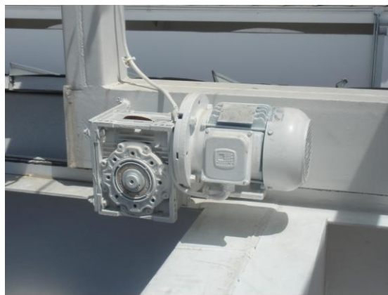
Fotografía 2.23: Motor de la cubierta mecanizada del Mall “San Luis”.
