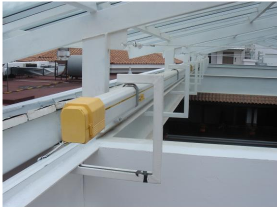
Fotografía 2.25: Sistema eléctrico de la cubierta mecanizada del Mall “San Luís”.
