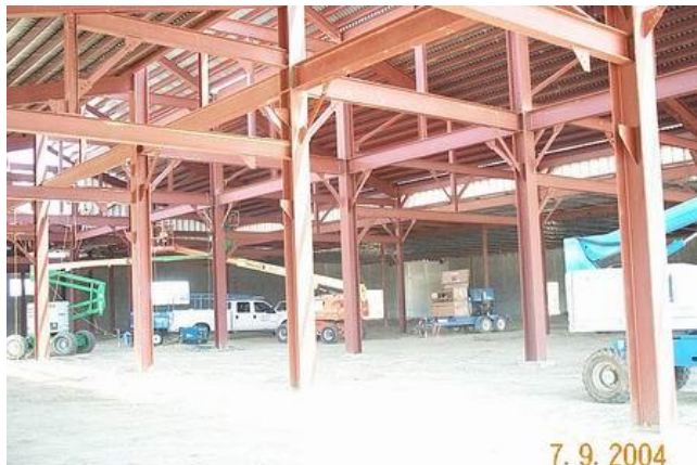
Fotografía 2.13: Ejemplo de estructura de acero pesada.
