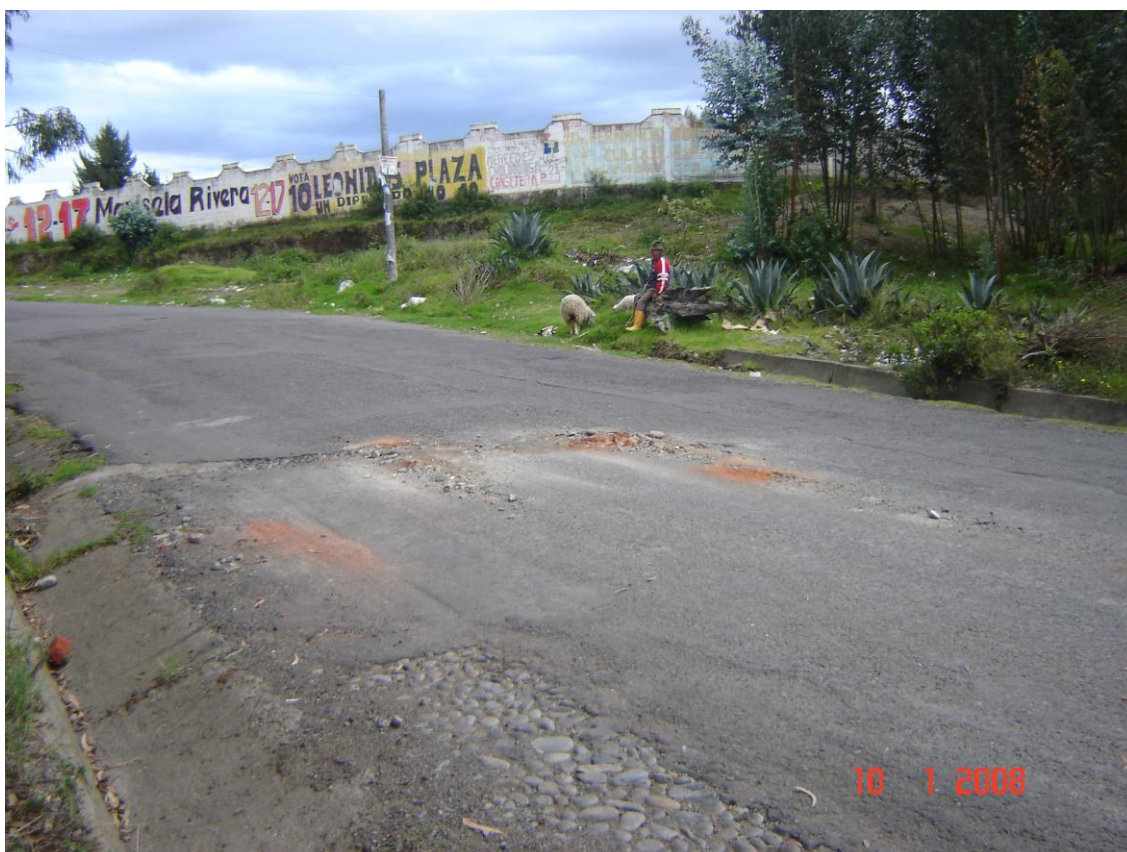
Figura C.3 Falla de la red existente (entrada a Aláquez)
