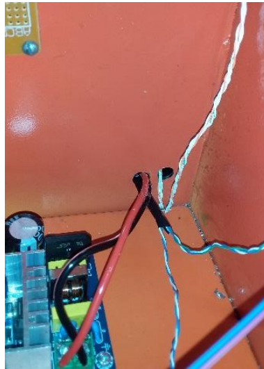
Figura 78. Cableado de los elementos
