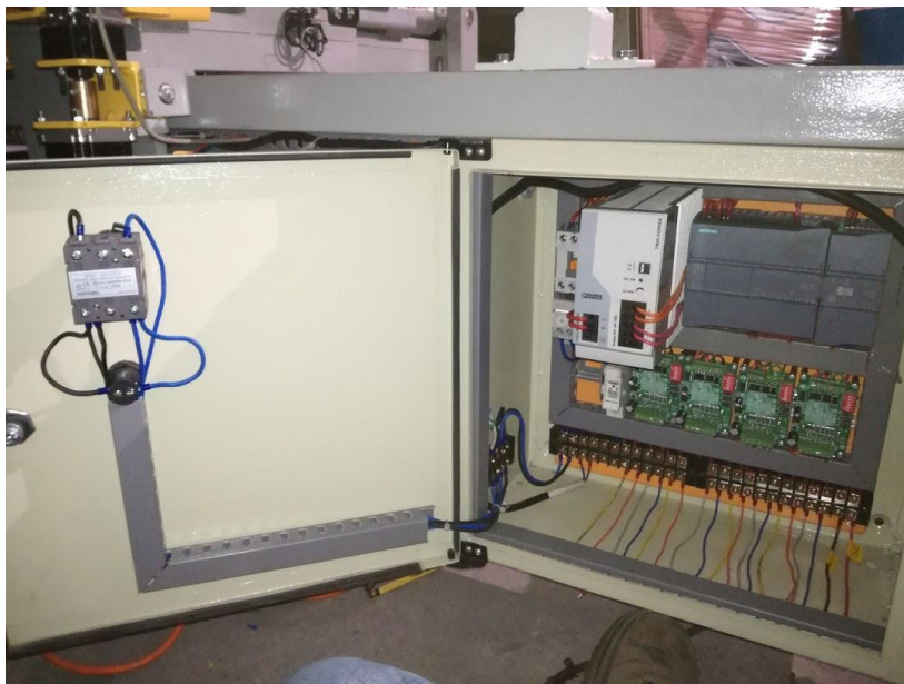
Figura 96. Tablero de control
