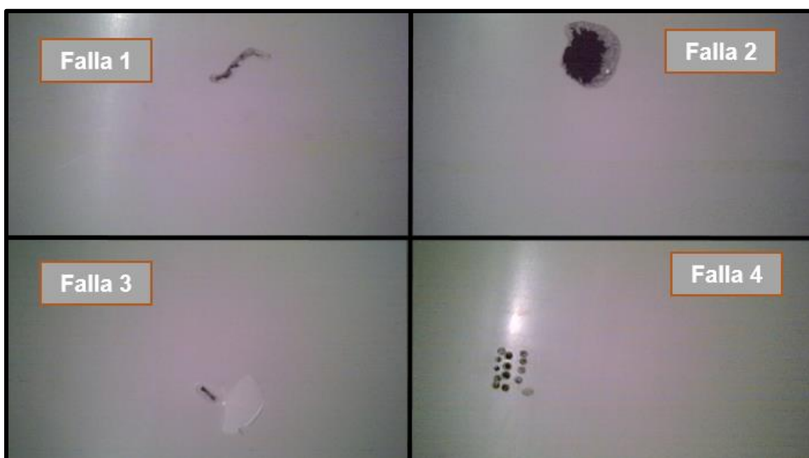
Figura 99 Fallas realizadas en la tubería
