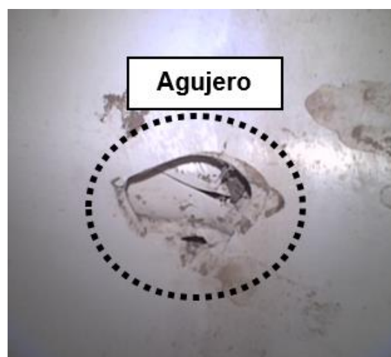
Figura 24 Agujeros en tuberías
