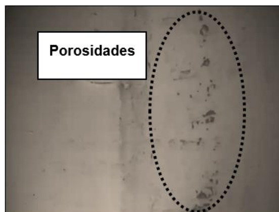
Figura 22 Porosidades en tuberías
