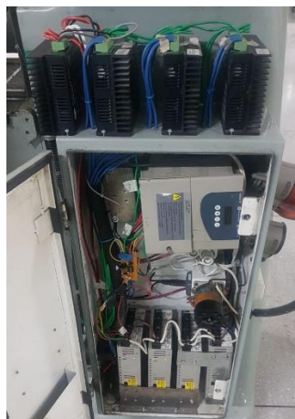
Figura 25. Driver y fuente del motor a pasos instalados Fuente: Propia
