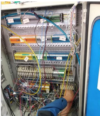
Figura 107. Reconexión de borneras.
