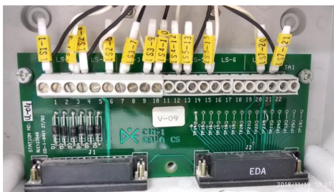
Figura 108. Placas controladoras pertenecientes a cada una de las estaciones.
