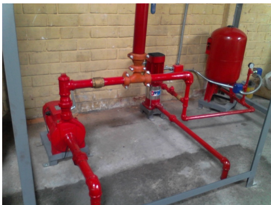
Figura 24. Sistema contra Incendios.
