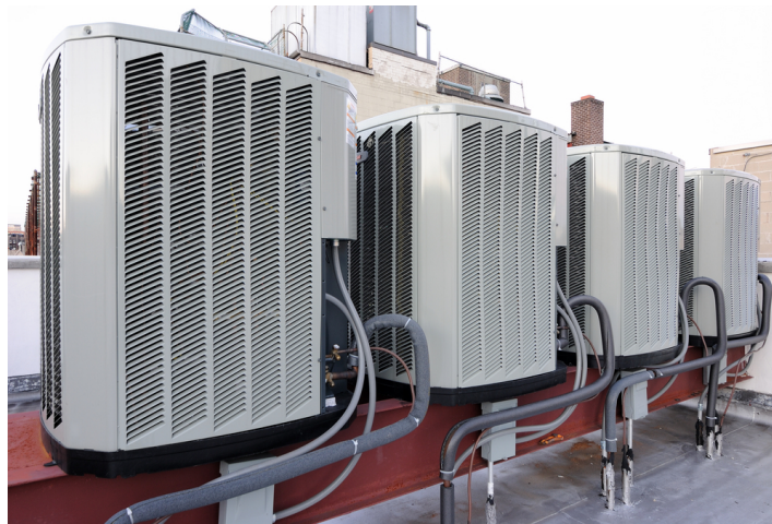
Figura 18. Equipos de Climatización.
