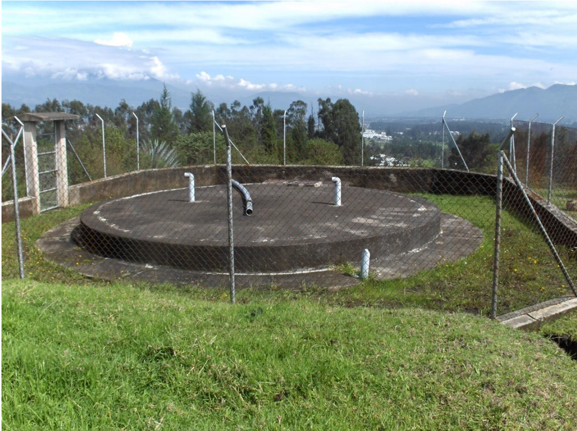
Tanque de Distribución (Reserva), Fotografía 3
